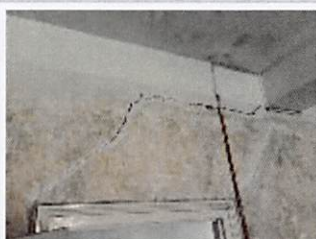
Gros œuvre et structure (fissures)
