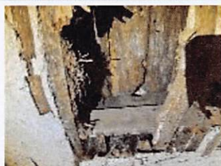
Charpente et couverture (infestation)
