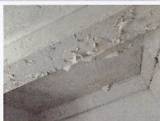
Fissures parois intérieures
