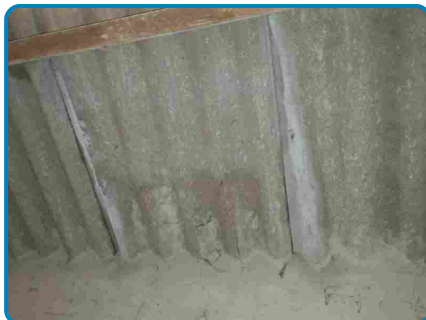
D.O. n° 2 sur Toiture Plaques ondulées en fibres ciment
