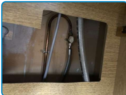
Anomalie 8a2 (A1) sur Install.n°1 Appareil n°2
