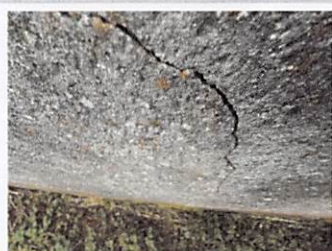
Gros œuvre et structure (fissures)
