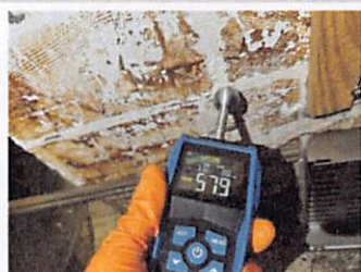
Gros œuvre et structure (humidité)
