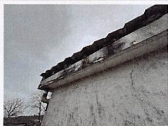
Toit terrasse (infiltrations)
